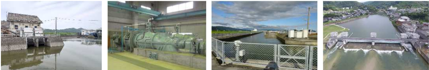
友田排水機場：国営（写真左）及び市営（写真右）の排水機場を廃止、新たに機能強化した排水機場を整備 久保田第2排水機場内部の排水ポンプ 右岸幹線水路：各施設・設備の整備・更新 川上頭首工：各施設の整備・更新
